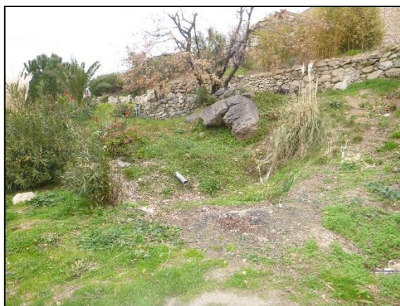
Photo 3 : Point de rejet des eaux pluviales du hameau de CHIOSE (TPAe, le 18/09/2019)
