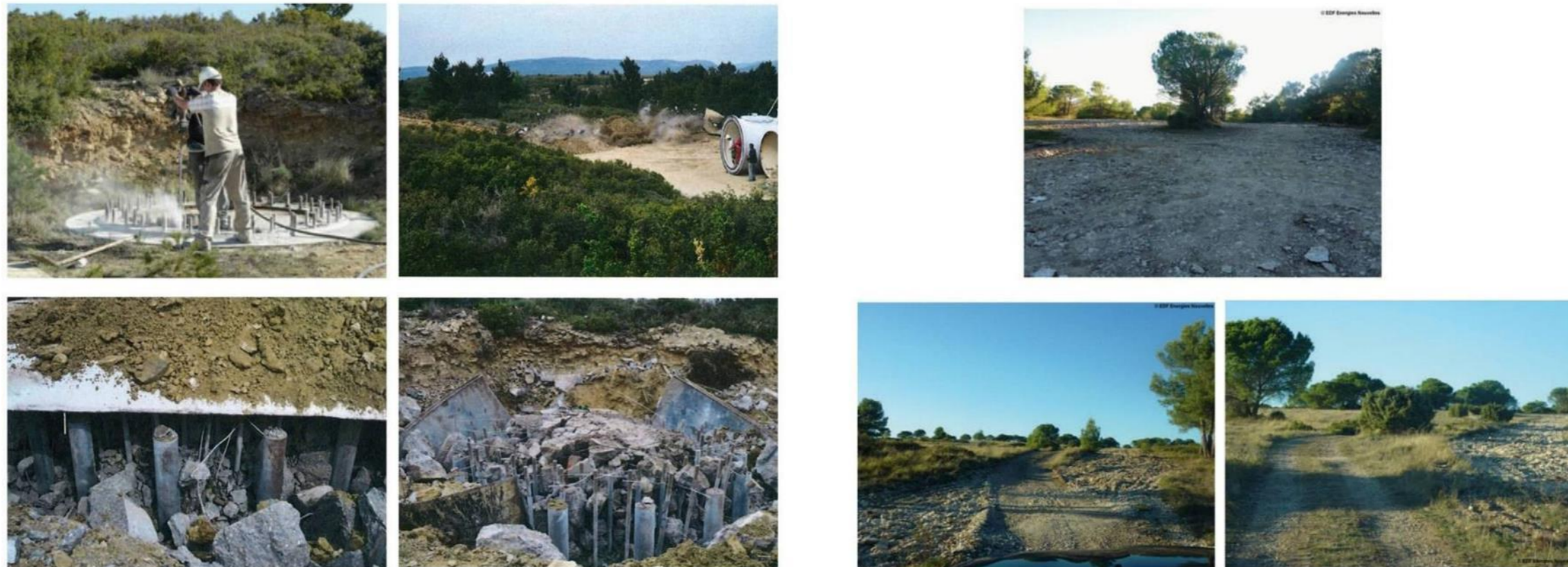
8 - Mise en place et mise à feu des explosifs pour destruction des fondations et évacuation vers les filières adaptées de gestion des déchets
