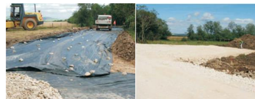
Photographie 5 : Pose d'un géotextile (à gauche), état final d'une plate-forme (à droite) (Source : EDF Renouvelables)
