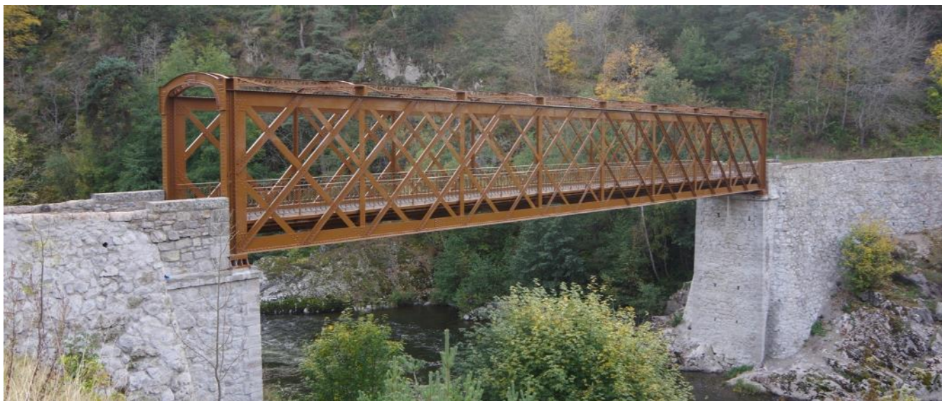
Photographie 147 : Pont de Jonchères au-dessus de l'Allier, aux abords de la Côte de Jonchères
