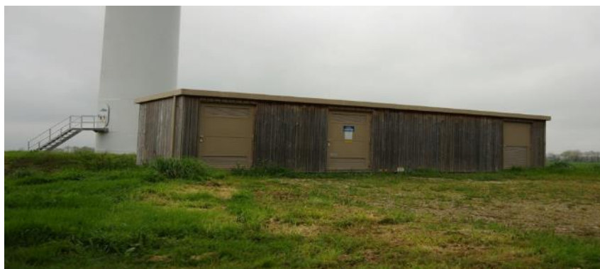
Photographie 6 : Exemple de poste électrique bardage bois
