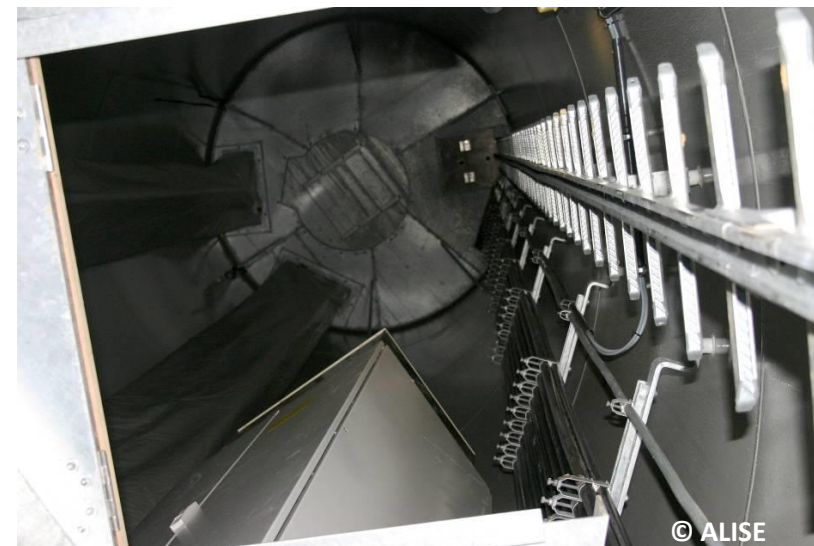
Photo 6 : Intérieur du mât d'une éolienne (échelle d'accès)
