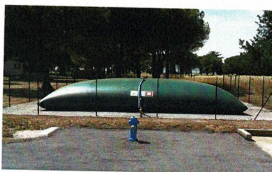
Illustration n°8 : Photographie d'une Réserve d'eau incendie souple.
