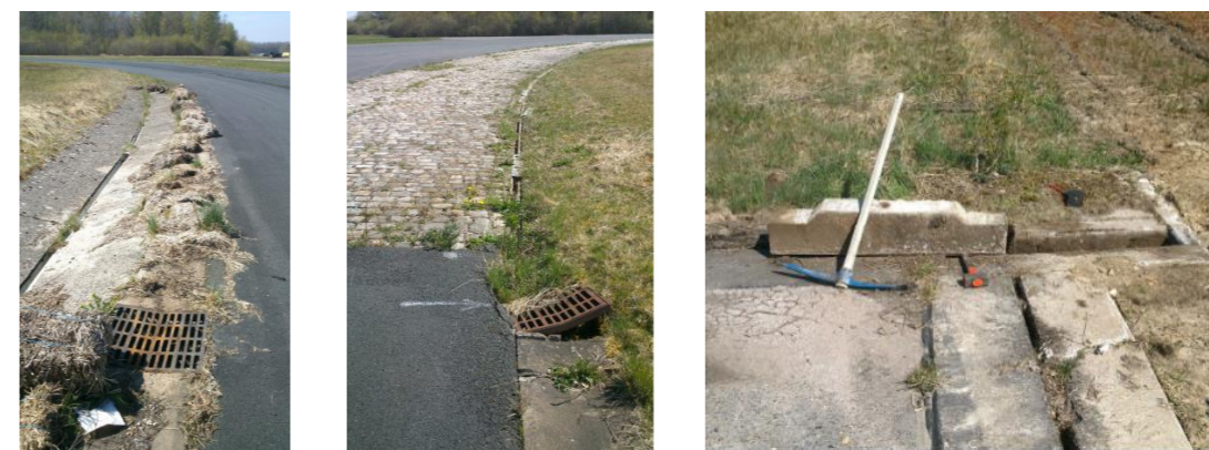
Photo 5 : Ouvrages de gestion des eaux pluviales existants (source : Dossier loi sur l'eau)
