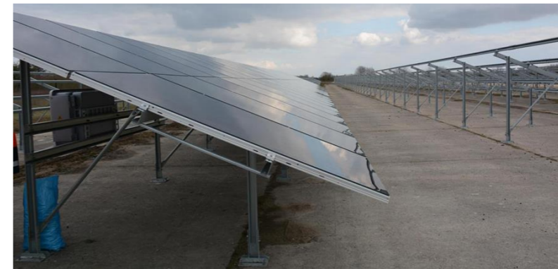
Structures photovoltaïques sur le site de l'aérodrome de Marigny (51) (source : CVE)
