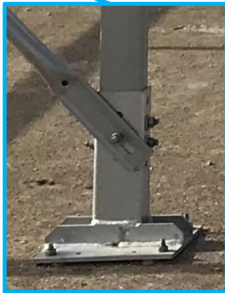
Figure 2: Photo des structures et ancrages du projet photovoltaïque de l'aérodrome de Marigny
