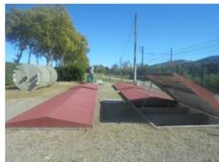
Station d'épuration de Floure
