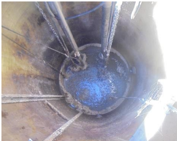
Poste de relevage des eaux brutes
