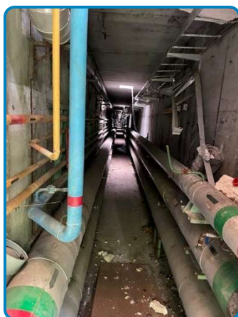
Intérieur galerie technique
