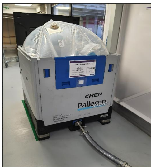
Equipement de transfert connecté à la ligne de répartition
