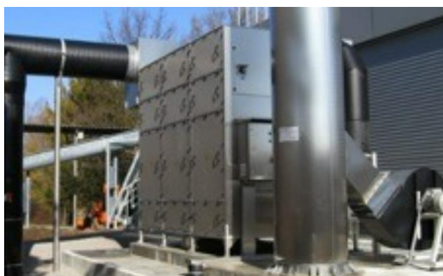
Système de traitement de l'air par UV (photo-catalyse)
