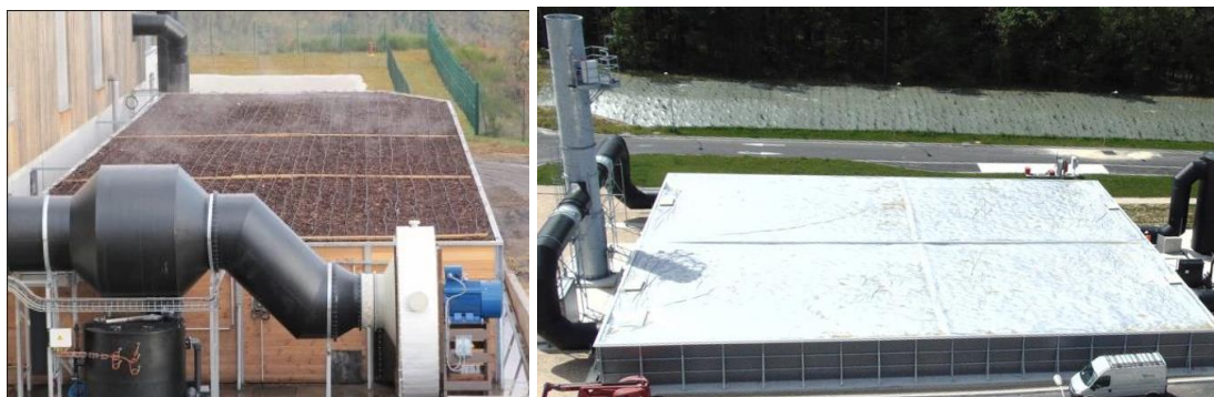
Système de biofiltration ouvert (à gauche) et clos (à droite) Source : John Cockerill
