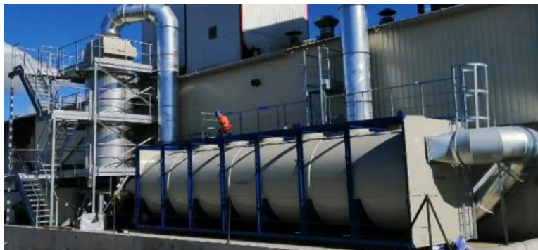
Système de traitement d'air cyclo filtre et ligne de caissons de charbons actifs Source : CLAUGER
