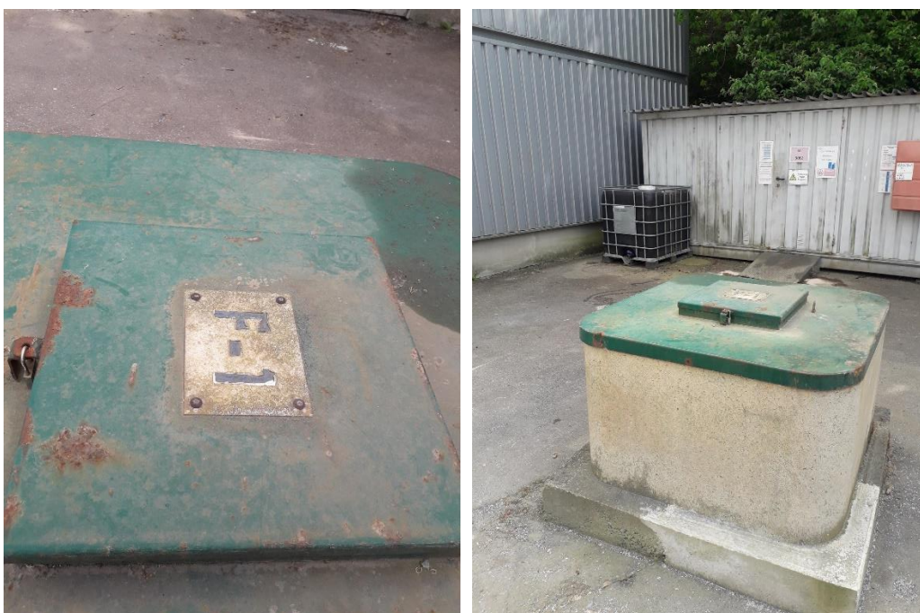
Figure 39 : Protection de la tête de forage actuel du site de Taden
