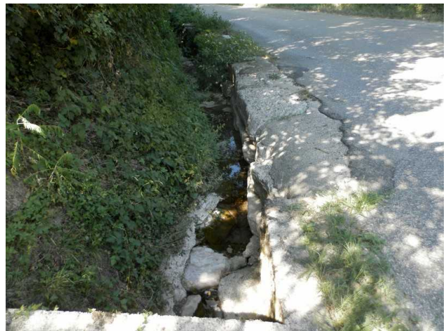
Photo 22 : Une partie du fossé de la Montée du Pillard a été réalisé en enrochement.
