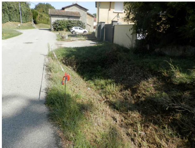
Photo 8 : Le fossé et la buse le long du chemin du Trièvoz-Gillet sont sous-dimensionnés.
