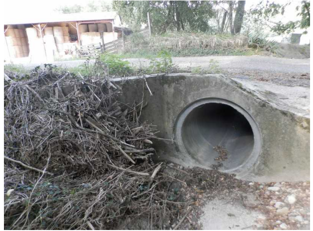
Photo 14 : Des divagations sont possibles vers la ferme du lieu-dit Les Allouets située à proximité de l'exutoire de la combe. De nombreux branchages sont visibles et peuvent obstruer la buse.
