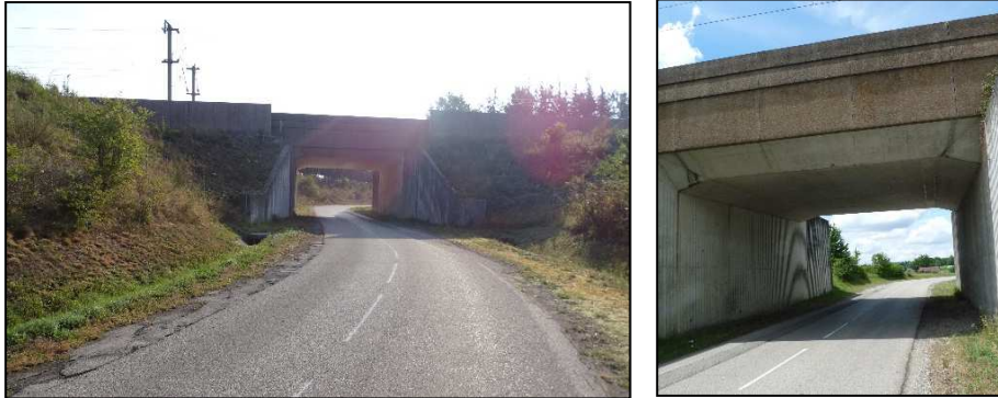
Passage de la route de Ponas sous la LGV, maintien d'une bande enherbée latérale sous l'ouvrage
