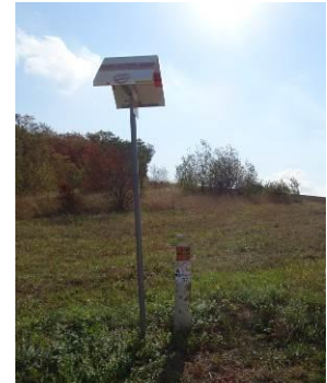
Canalisation d'éthylène Chemin des Pires
