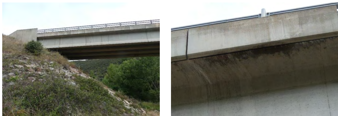
Pont dans lequel se trouve la colonie de Pipistrelle pygmée et détail de l'entrée du gîte
