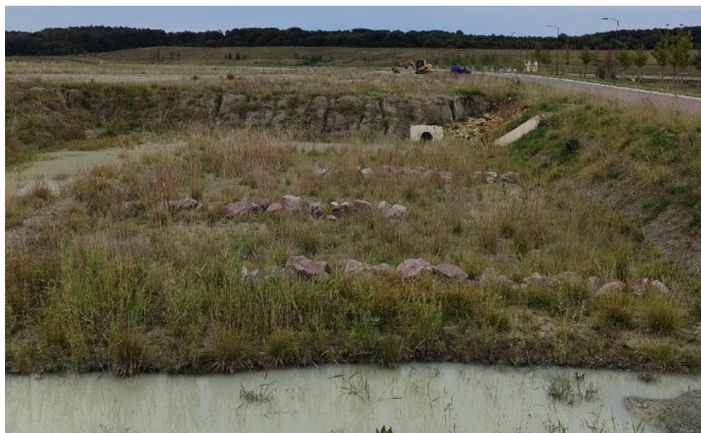
Bassin de gestion des eaux pluviales
