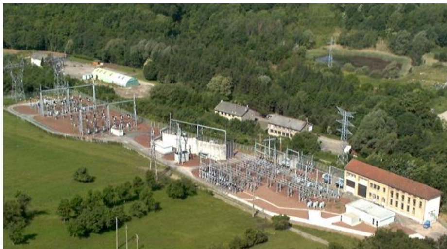
Vue du poste 225 000 /63 000 volts de Sarreguemines dans sa configuration actuelle (Source RTE)
