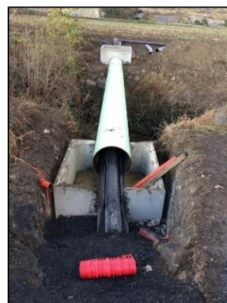
Tube contenant les câbles (Source RTE)
