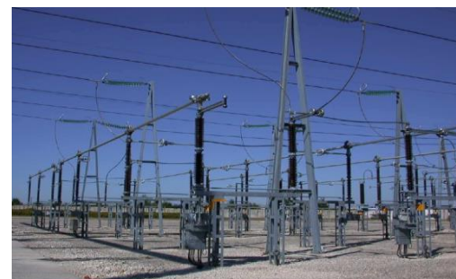
Superstructures et petits équipements (Crédit RTE)
