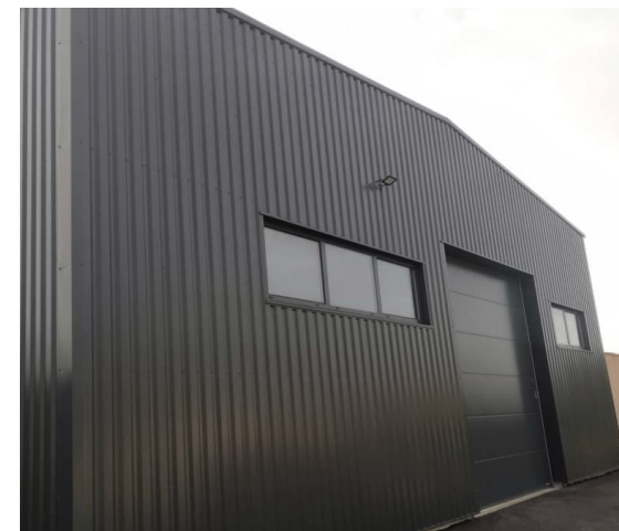
Bardage métallique vertical type trapeza – RAL 7043
