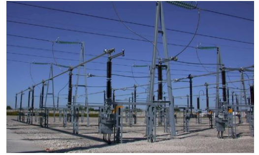
Superstructures et petits équipements (Crédit RTE)
