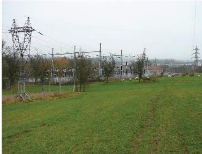
Poste électrique de Sarreguemines
