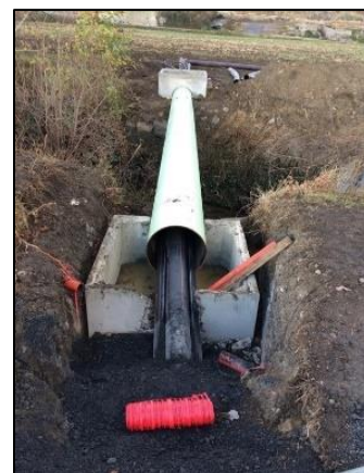
Tube contenant les câbles (Source RTE)
