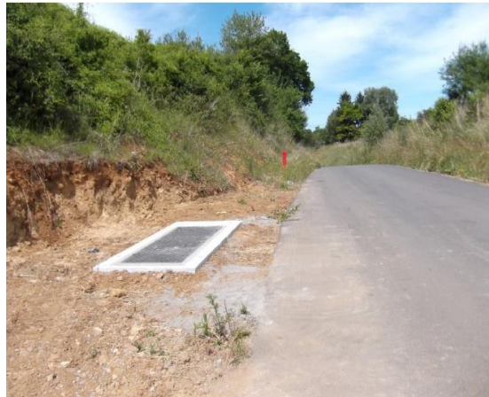
Un puit de terre (Source RTE)
