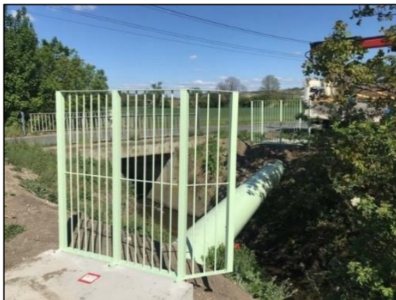
Protection du tube contenant les câbles (Source RTE)
