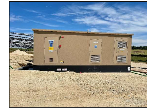
Exemple de poste de livraison
