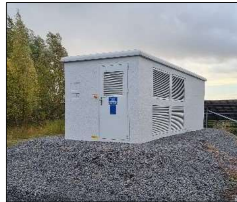
Exemple de poste de transformation
