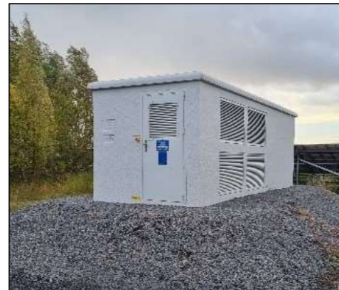
Exemple de poste de transformation
