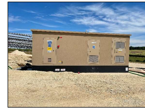
Exemple de poste de livraison
