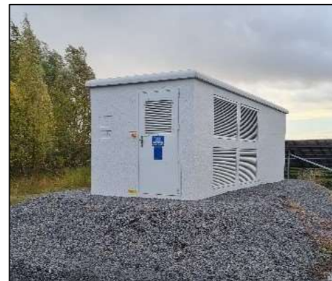
Exemple de poste de transformation
