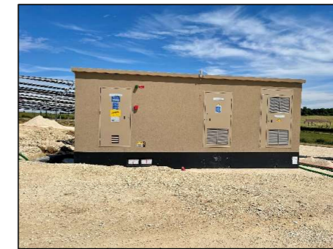
Exemple de poste de livraison
