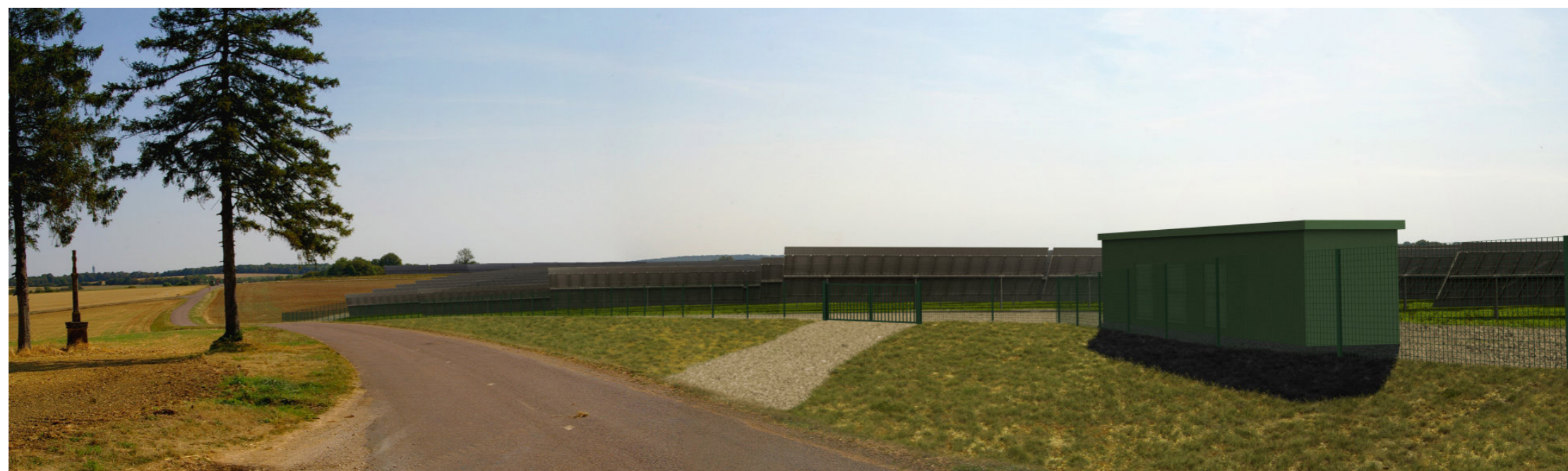
Vue 1: Vue de l'entrée secondaire et du poste de transformation 1 du projet à l'Ouest de la centrale solaire depuis la départemental n°7 (sans la haie).
