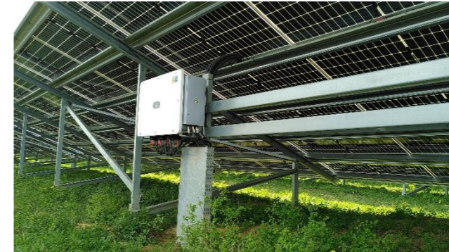
Exemple d'onduleur accroché derrière les tables de modules
