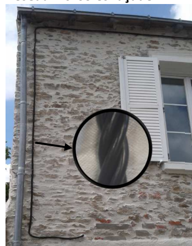
Réseau fils isolés façade BT
