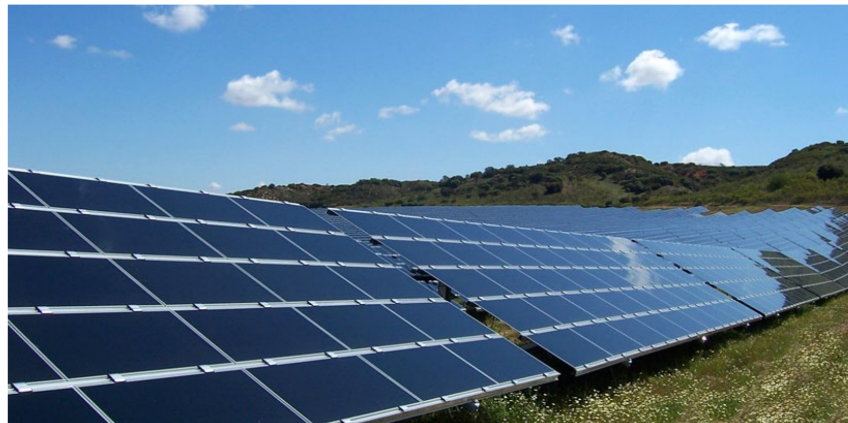
Parc photovoltaïque EDF Renouvelables de Narbonne
