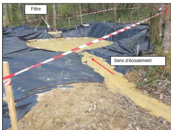
Figure 178 : Exemple de bassin de décantation en limite de piste connecté à un fossé de collecte des eaux pluviales
