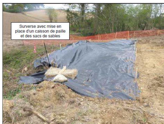
Figure 176 : Exemple de merlon de protection en L recouvert de géotextile fixé par des pieux de bois sur sol imperméable
