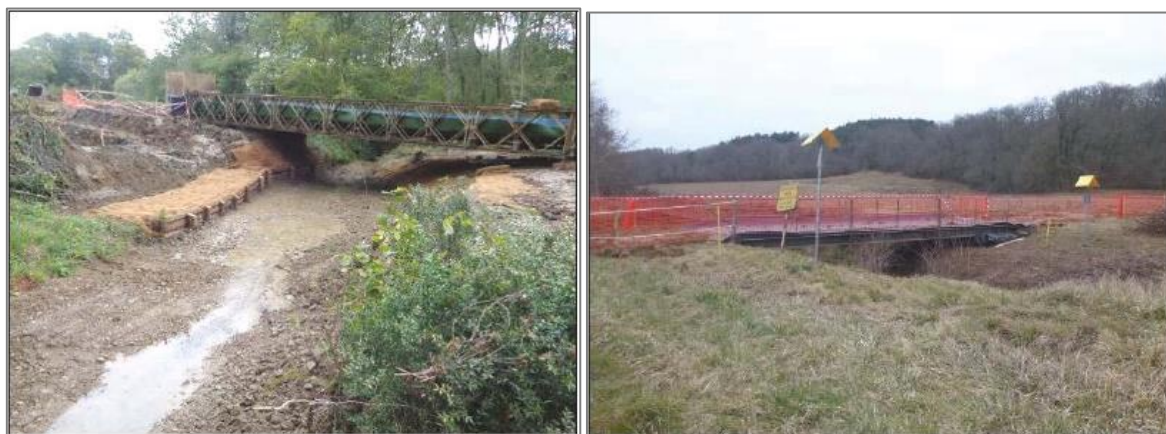
Figure 51 Exemples de ponts (photo : TEREGA)
