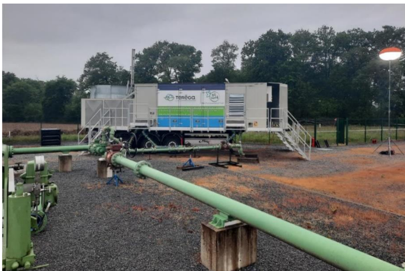
Figure 150 : Camion de recompression (Source : Teréga)
