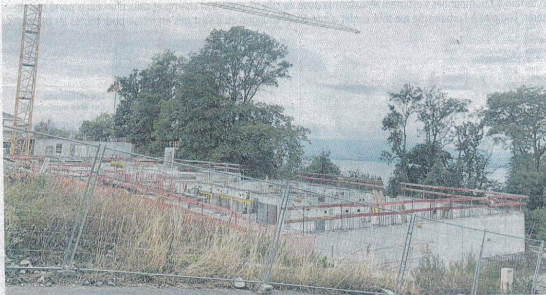
La construction des trois premiers immeubles du vaste programme immobilier des Tours a commencé.
