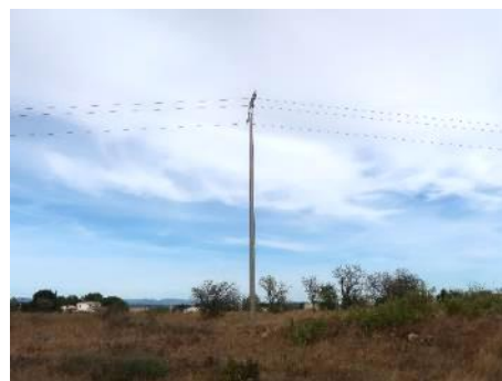
Ligne aérienne haute tension au droit du site d'étude
