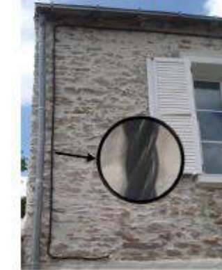
Réseau fils isolés façade BT
