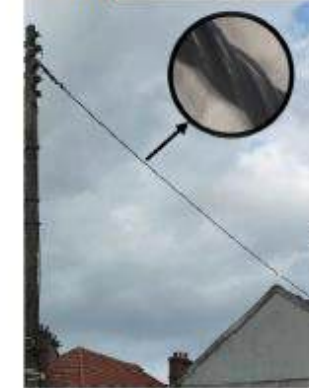
Réseau fils isolés aérien BT
