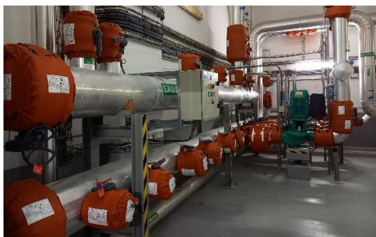
Image 2 : Matelas isolants sur les réseaux chauds et vapeurs
