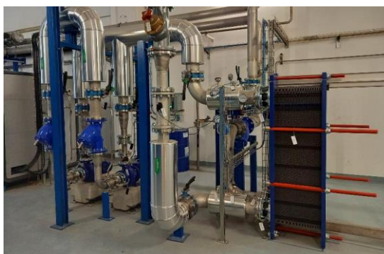
Image 1 : Système de récupération de chaleur sur l'ACS C300
