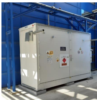
FIGURE 18 : ARMOIRE DE RECUPERATION DES EFFLUENTS SOLVANTES
