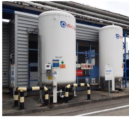
FIGURE 9 : EXEMPLE DE STOCKAGE D'AZOTE LIQUIDE REFRIGERE
