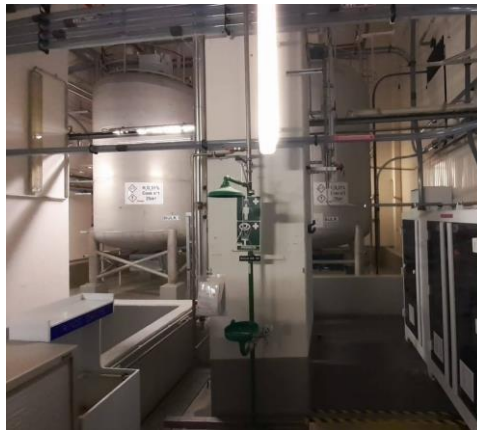
FIGURE 7 : CUVES DE STOCKAGE BULK (CUVE DE PEROXYDE D'HYDROGENE H 2 O 2 ) DANS LEUR RETENTION
