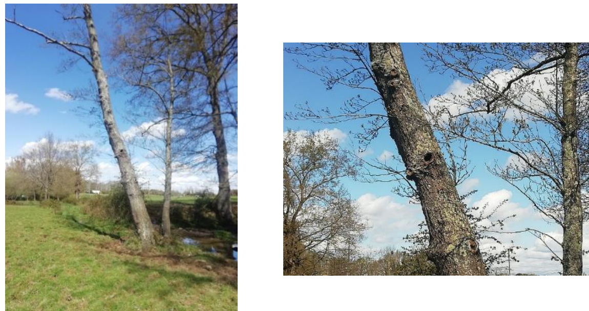
FIGURE 162 : ARBRE AVEC UNE CAVITE PROCHE DU RUISSEAU (SOURCE : EGIS, AVRIL 2022)
