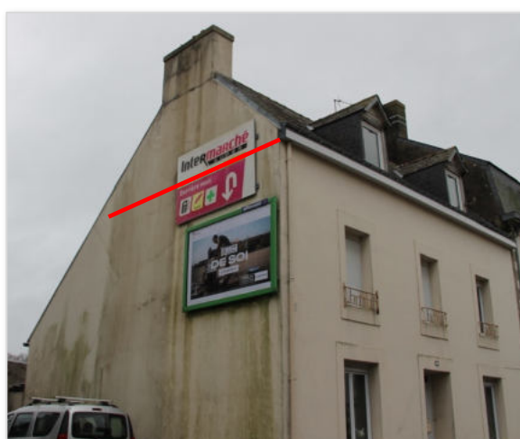
Dépassement de la ligne d'égout du toit
