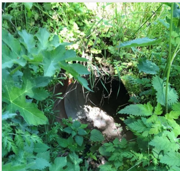
Figure 7 : Conduite sous voirie, permettant l'intégration d'une partie du BV BNM2
