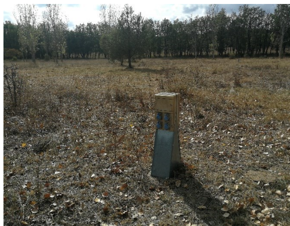
Repérage des points de raccordement électrique
