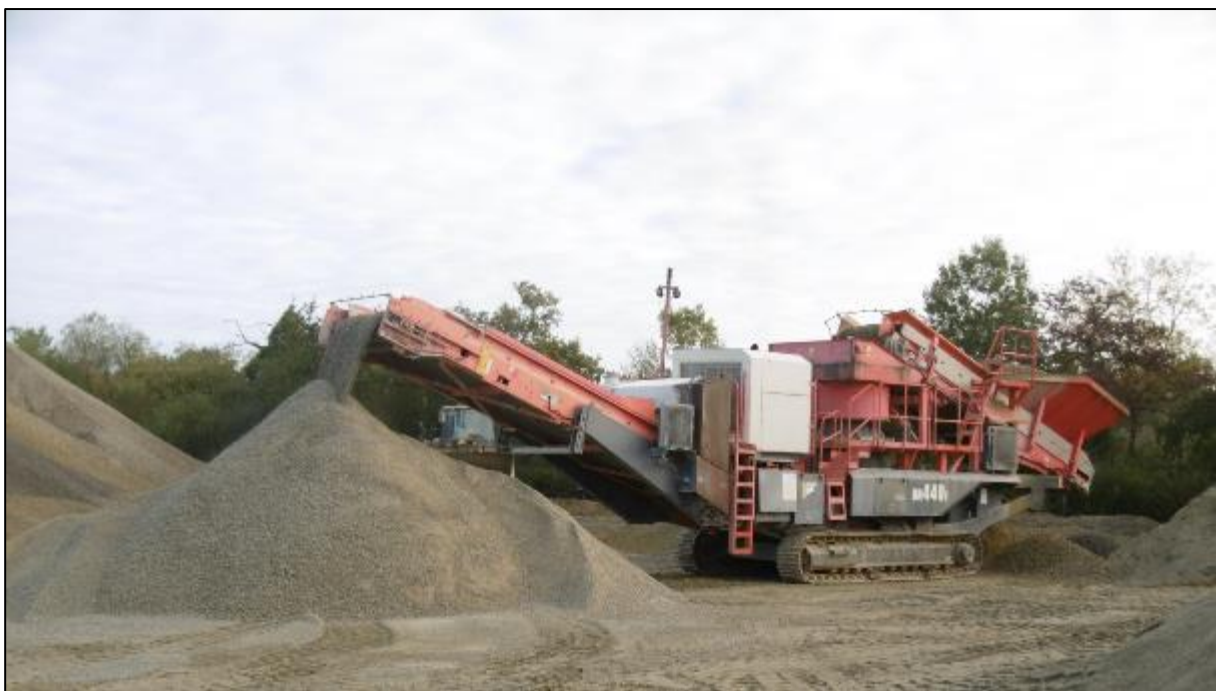
Figure 10 : Visuel d'une installation mobile de concassage et de criblage semblable à celle prévue (site de Saint Pazanne)
