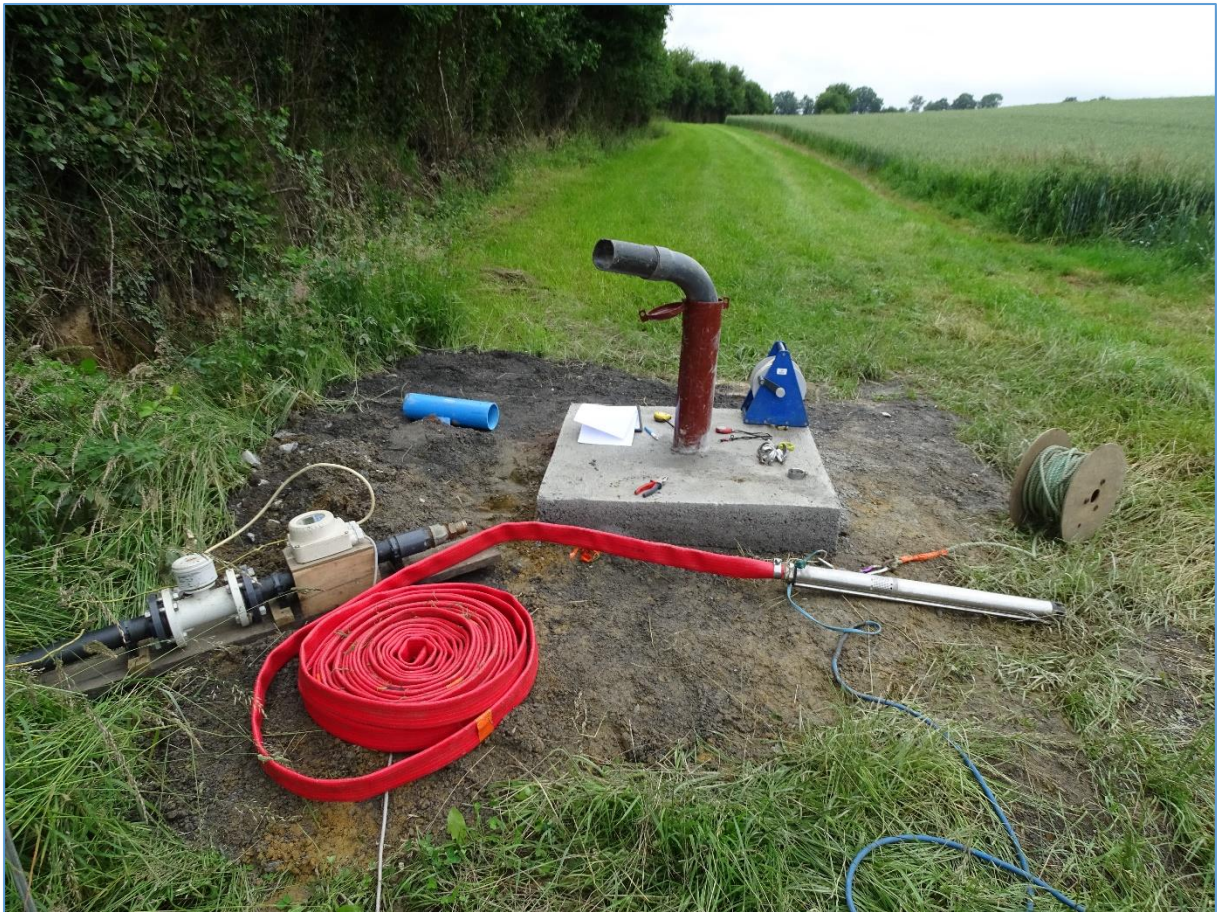
Fig. 25 : Equipement de l'essai de pompage au droit de PZ2
