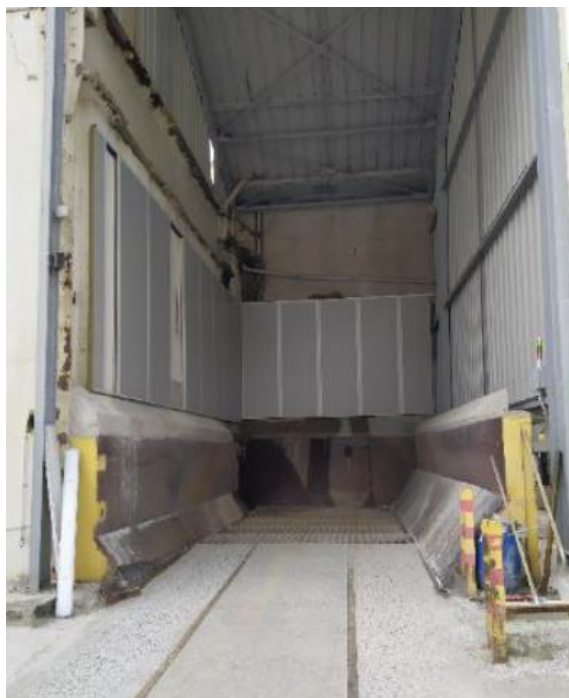
Figure 83 Ecrans acoustiques mis en place au niveau de la fosse de déchargement de calcin – Elévateur four 3 – Façade Est
