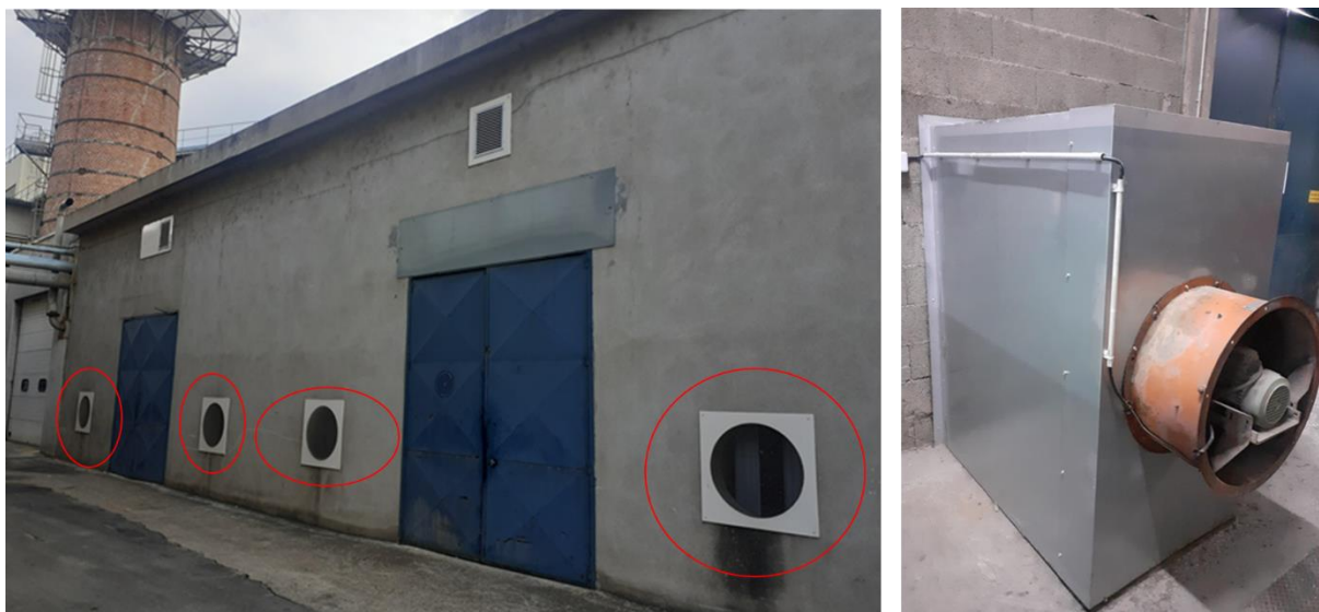
Figure 82 Protection acoustique dans la salle compresseurs site 1 – façade Ouest
