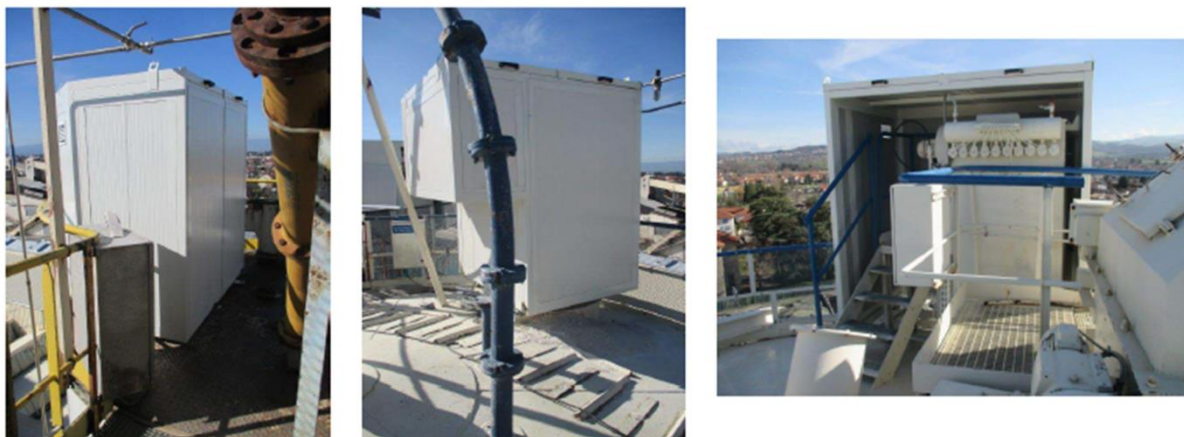
Figure 81 Protections acoustiques sur les dépoussiéreurs - Tête des silos de matières premières - Façade Est
