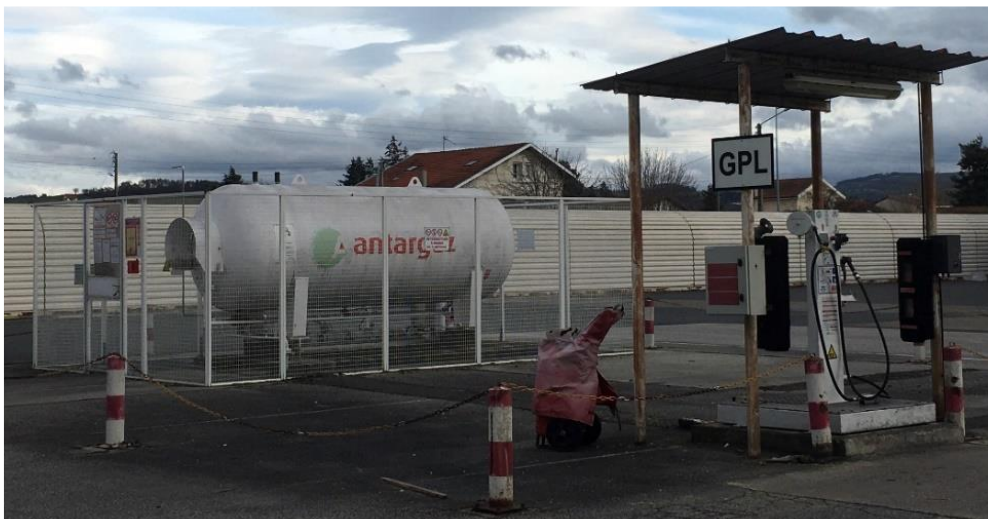
Figure 44 Station de distribution de GPL et cuve associée (source : POI du site – version 18 - avril 2021)
