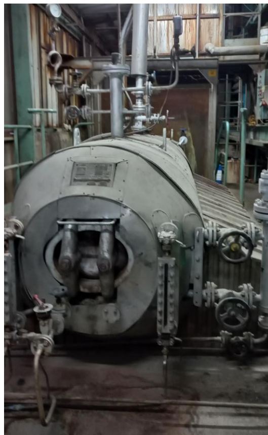
Figure 49 chaudière de récupération
