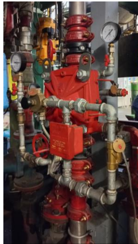
Figure 36 Equipement lié au système de déluge
