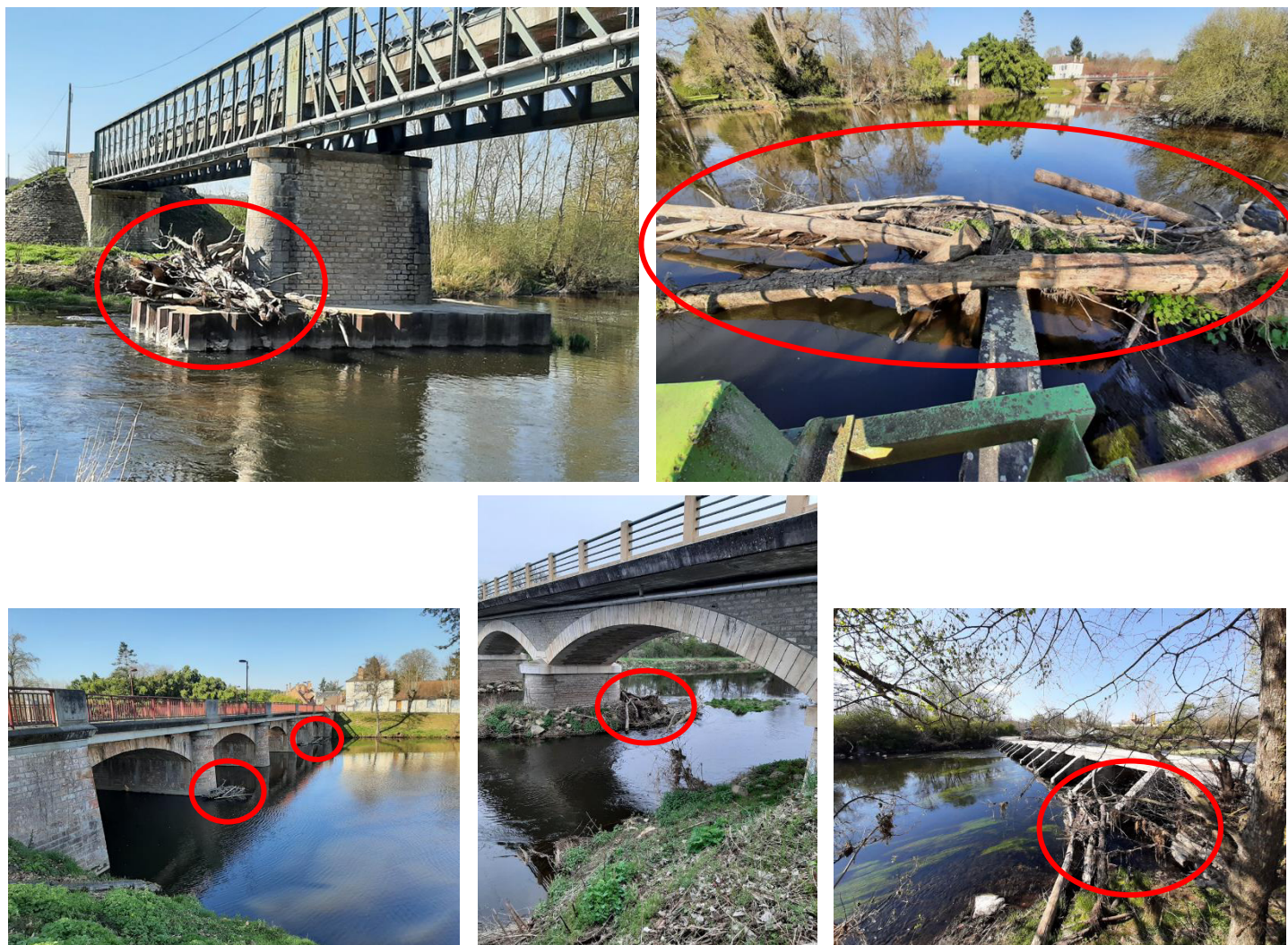
Figure 11 : Présences d'embâcles au niveau des ouvrages de franchissement sur le Cher et l'Aumance (source : Antea Group)
