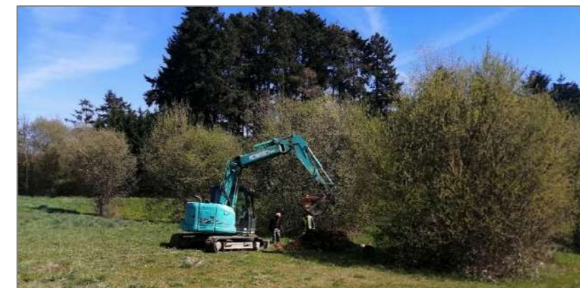
Photographie 50 : Sondages géotechniques en vue d'étudier des fondations-pieux non impactantes (Source : ENCIS Environnement)
