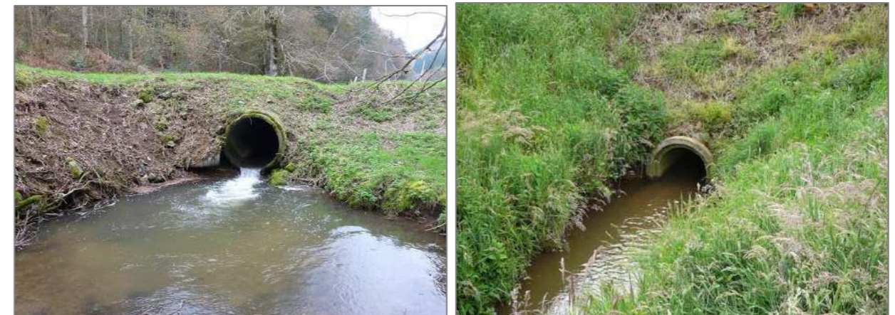
Photographie 52 : Exemple d'une buse mal calée (à gauche) et d'une buse correctement installée (à droite) (Sources : SYRIBT à gauche et Bassin versant Vilaine amont à droite)
