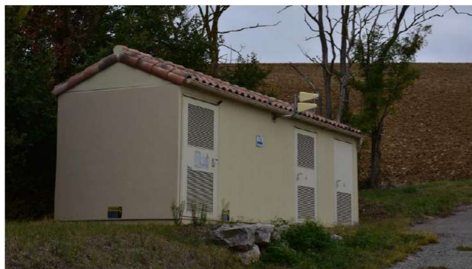
Photographie 54 : Poste de livraison du parc éolien de Calmont imitant les caractéristiques architecturales locales
