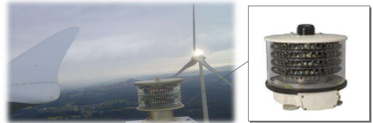
Figure 49 : Balisage d'une éolienne
