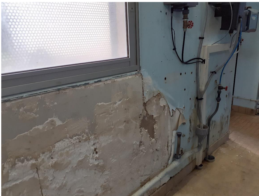
Figure 2-6 : Vue sur une partie dégradée du mur de la station de traitement (CPGF-HORIZON, photographie de la visite du 15 décembre 2020)
