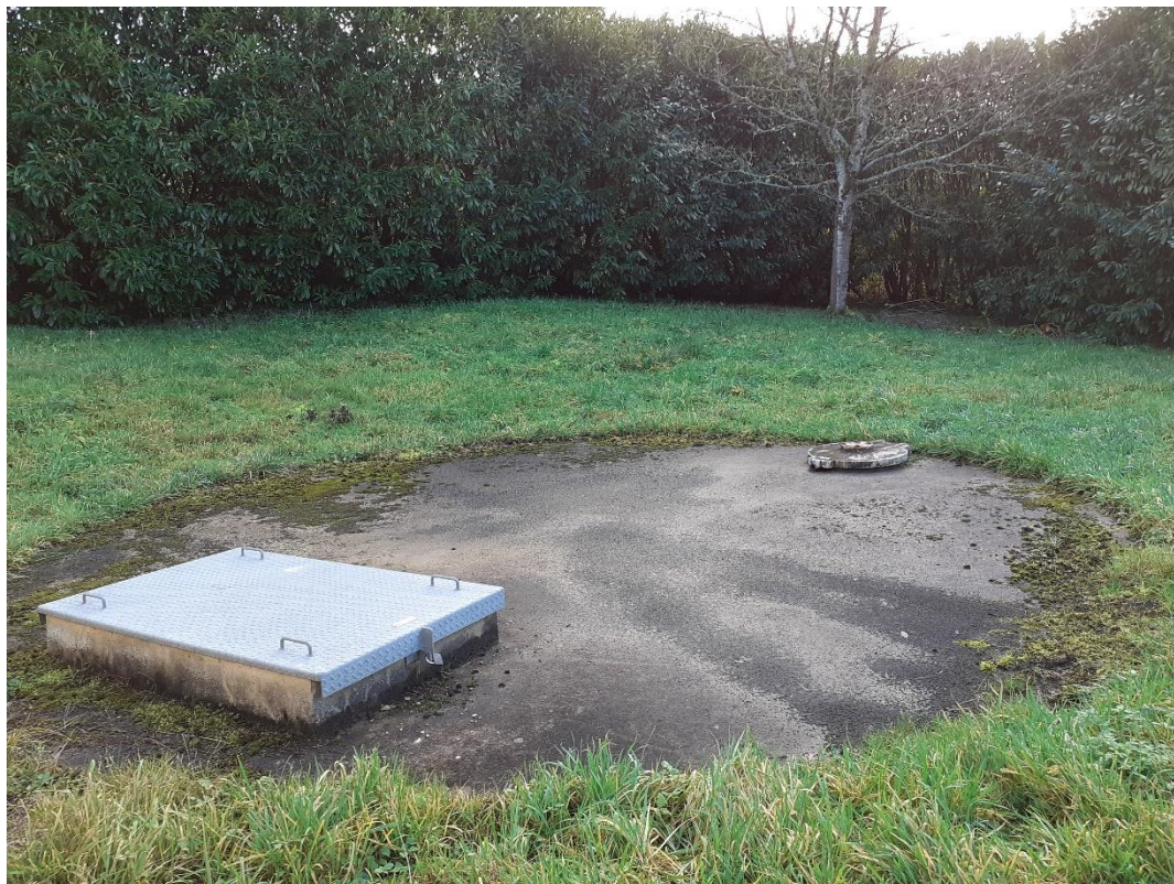
Figure 2-5 : Vue sur la bâche d'eau brute, capot fermé (CPGF-HORIZON, photographie de la visite du 15 décembre 2020)
