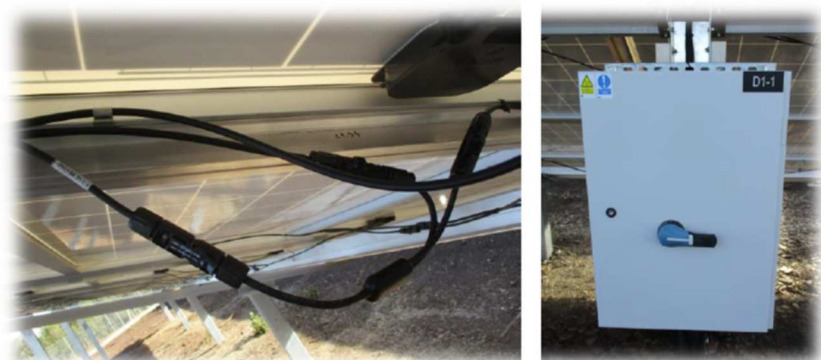
Exemple de câble électrique et de boîte de raccordement
