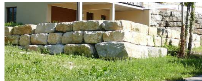
Utilisation d'enrochement pour combler une inadaptation à la pente - Le Souillot (Chapelle-d'Huin)
