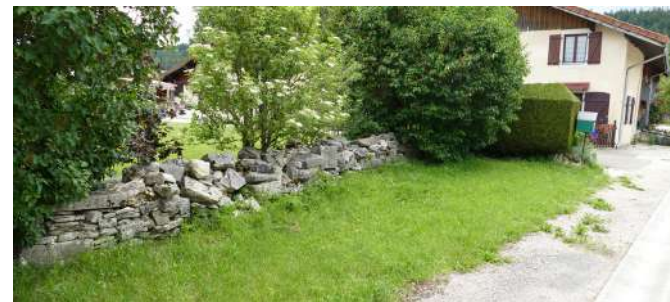
Muret bas en pierres qui se dégradent _Goux-les-Usiers
