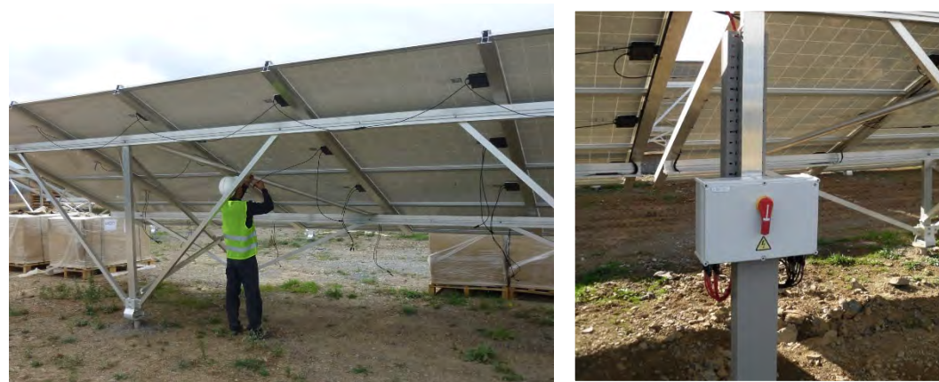
Figure 265 : À gauche : Câblage des panneaux – À droite : Boîtier de raccordement (source : Q ENERGY France)
