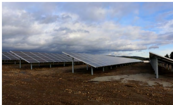
Figure 258 : Exemple d'espace non empierré entre tables (source : Q ENERGY France)
