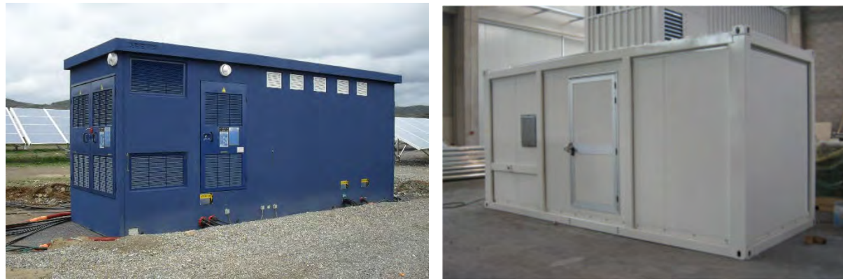
Figure 253 : Exemples d'onduleurs et transformateur installés dans postes béton et containers
