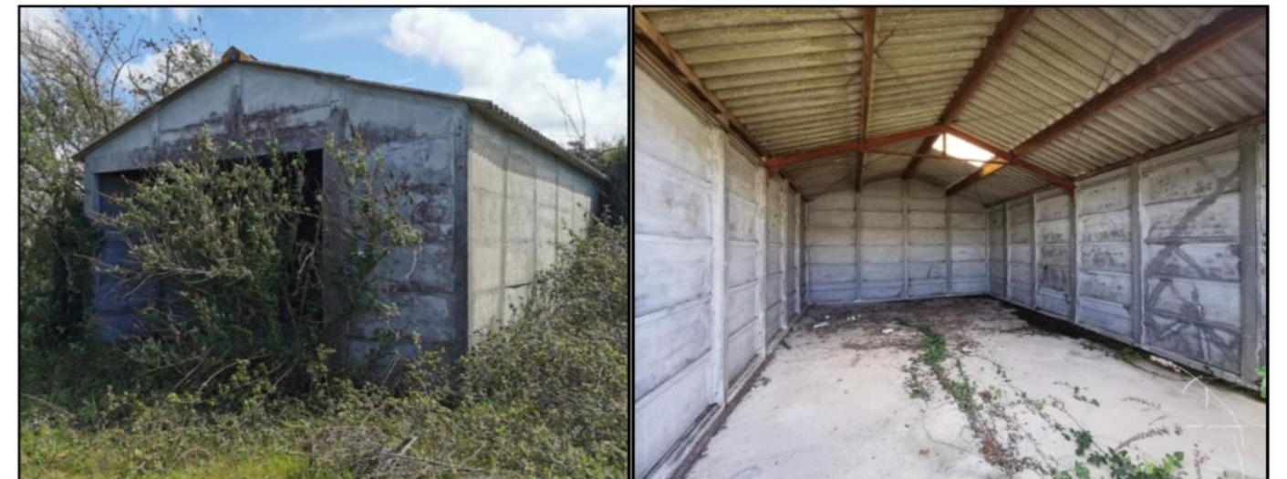
FIGURE 61 : HANGAR ABANDONNE (SOURCE : ARTELIA, 2023)
