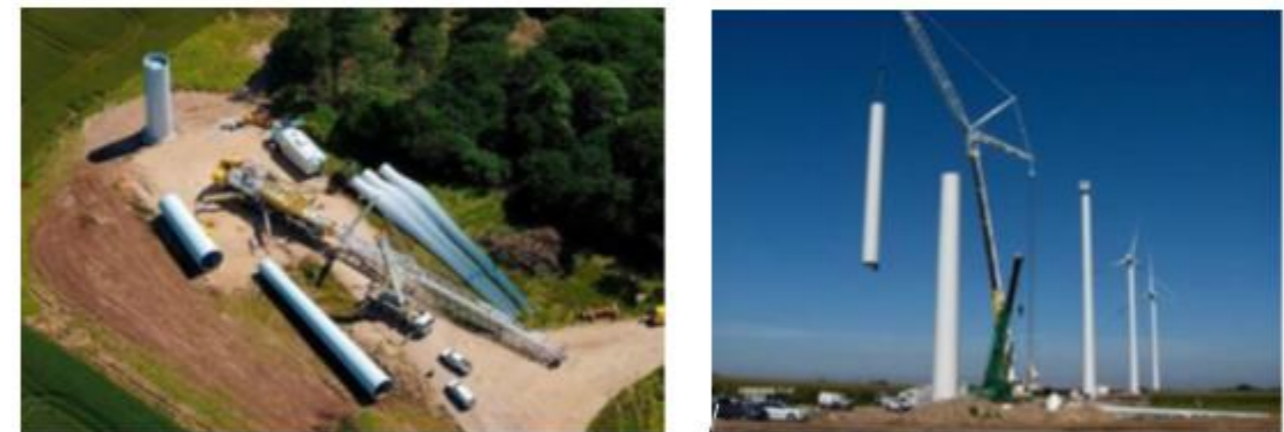
Vue d'ensemble des étapes d'assemblage de la tour (exemple de tour acier)
