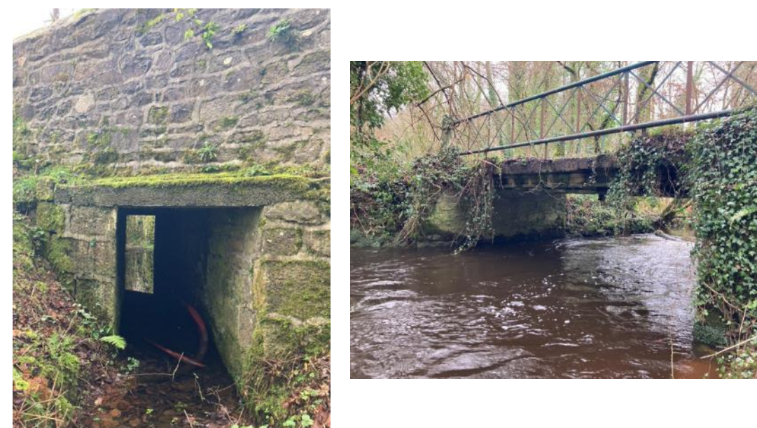
Figure 54. Ouvrages favorable (gauche) et défavorable (droite) au niveau de l'aire d'étude immédiate
