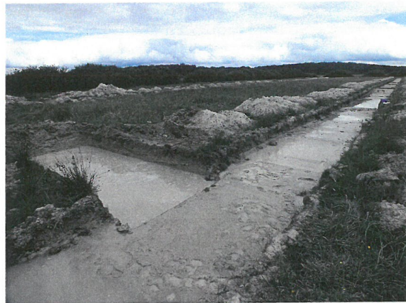
Figure 38 Une tranchée profonde a été creusée pour drainer les eaux qui noyaient le locus F35. Le fond de tranchée reste humide avec une couche de barbotine épaisse de trois à 5 centimètres.
