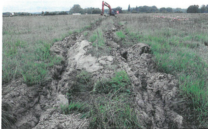
Figure 16 État du terrain et ornières après un seul passage de la pelleteuse.
